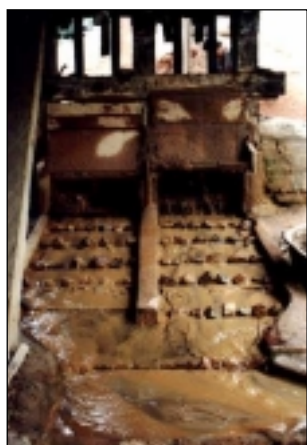
Figura 1. Estado Inicial Canaletas
