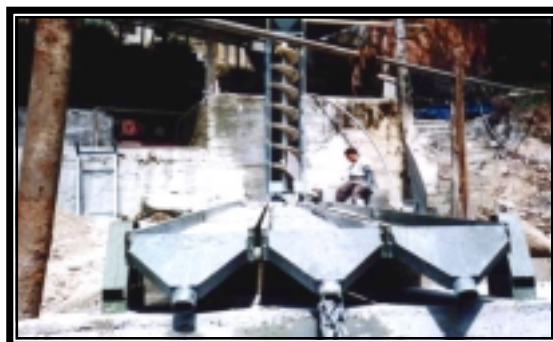
Figura 15b. Modificaciones en La Peter (Vetas). Concentrador en espiral y canaletas.
